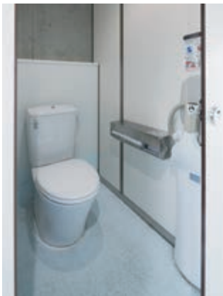
千葉浦安公園 災害対応型トイレとして設置
